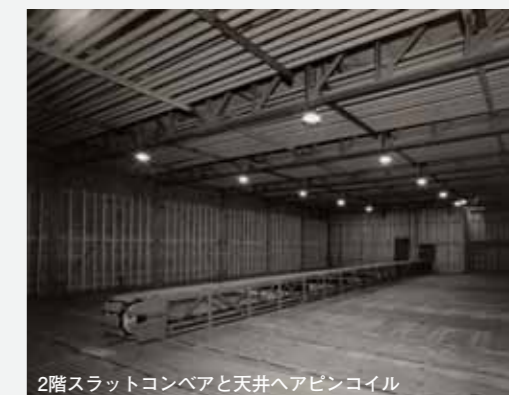
2階スラットコンベアと天井ヘアピンコイル
