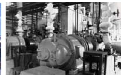
竣工当時のスクリー冷却機
