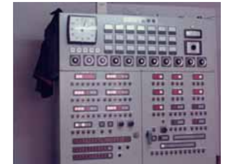
工務機械室の操作盤
