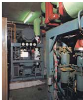
完成当時導入したアメリカ製冷凍機。
