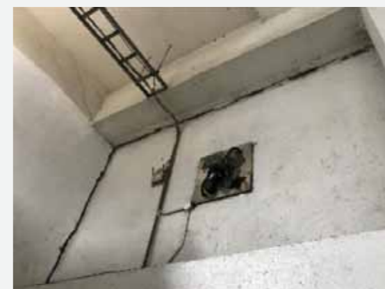
上層階の荷捌室の換気扇 よく見ると壁に亀裂が・・・
