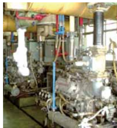
長谷川鉄工製冷凍機 (液ポンプ方式&集中型冷凍機)
