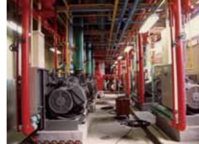
冷凍機 (凍結と保管の併用)
