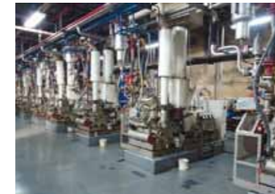
冷凍機7台を1カ所に設置する集中式を採用。 特定の冷蔵室を集中的に冷却できる。
