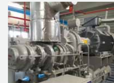
NH 3 /CO 2 凍結用冷凍機(前川製作所製)
