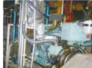
当社唯一のディーゼルエンジン付冷凍機 騒音・排ガス等の環境問題と燃料高騰により 2009(平成21)年に3台全て撤去した。
