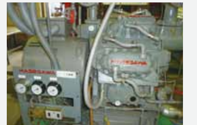
2号棟の高速多気筒冷凍機
