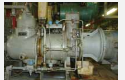
1号棟のスクリー式冷凍機
