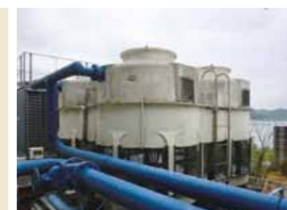
開放式冷却塔
