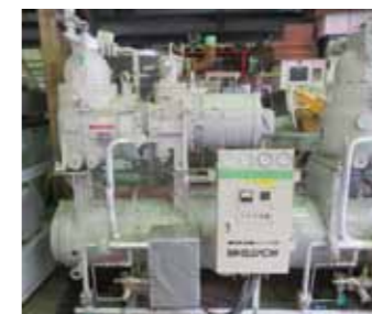
前川製作所製 MHS37CW スクリュー冷凍機 (圧縮機)
