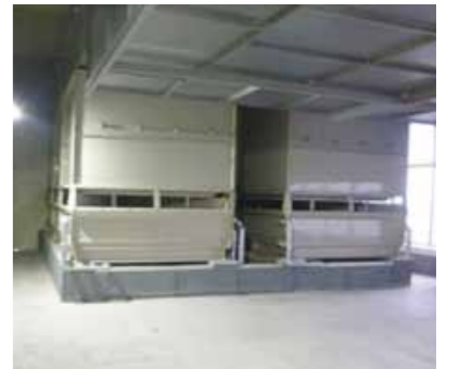
3階半屋外に設置されたエバコン(凝縮器)。
