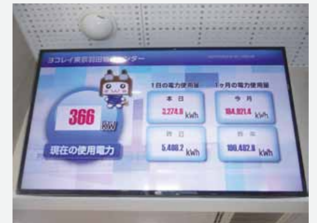
エネルギーモニター(東京羽田物流センター)
