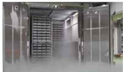
41.5トンの凍結が可能な凍結室を4室(合計166トン)設置。
