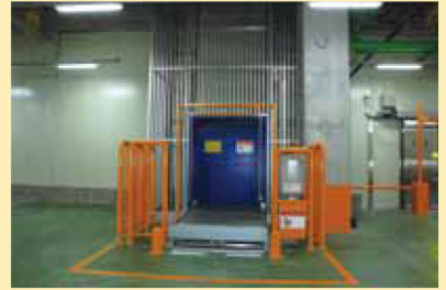
物流機器(電動扉、ドッグシェルター、エレベーター、垂直搬送機など)や冷却設備は、日本のメーカー製を導入。
