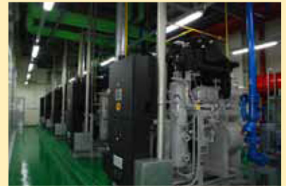
自然冷媒NH 3 /CO 2 式冷凍機のNewTon(前川製作所製)を導入。
