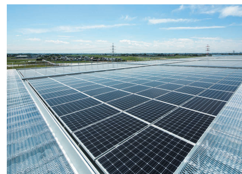
太陽光発電システムの導入
