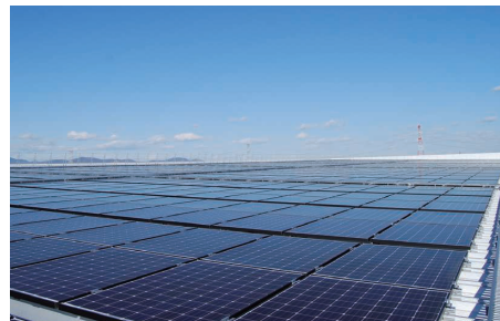
太陽光発電システム
