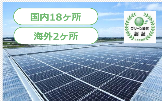
物流センターの屋上に設置された太陽光発電 モジュール
